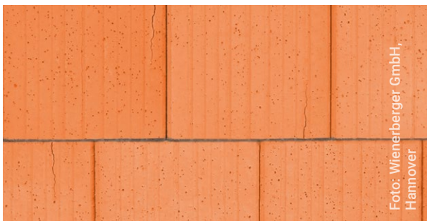
Bild 10: Ziegelmauerwerk mit Trocknungs- oder Brennrissen
